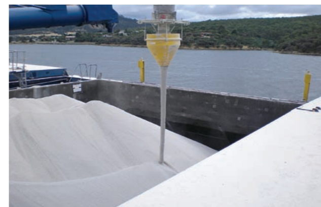
Después de la instalación del sistema DSH
